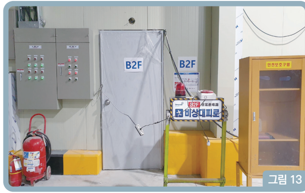
[그림 13] 비상경보장치 미작동 상태
