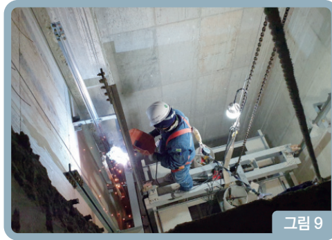
[그림 9] 승강기 용접 작업 시 불티비산 [그림 10] 승강기 출입구 앞 비닐 방치
